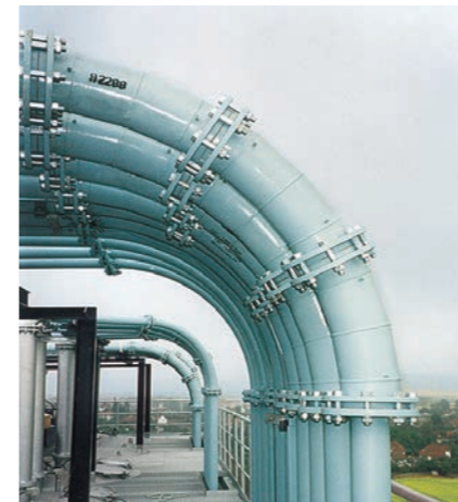
Защита пневматических и гидравлических трубопроводов
