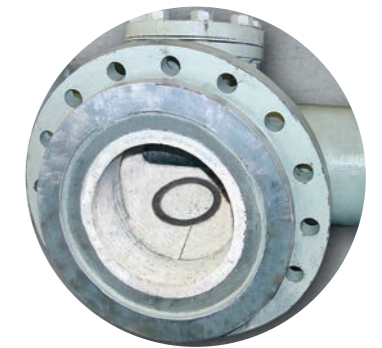
Разветвитель в подающем пневматическом трубопроводе имеет футеровку на основе KALCOR.
